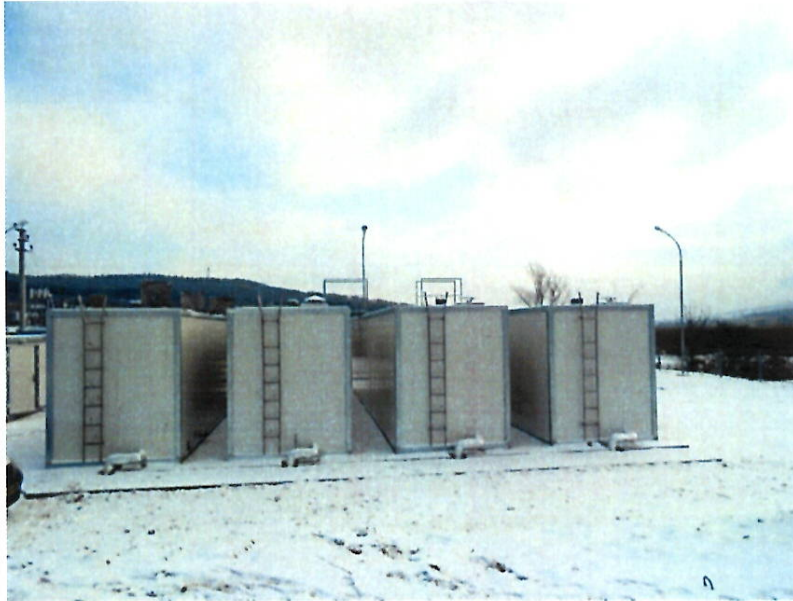
Stație de tratare ape uzate, tip MBBR
