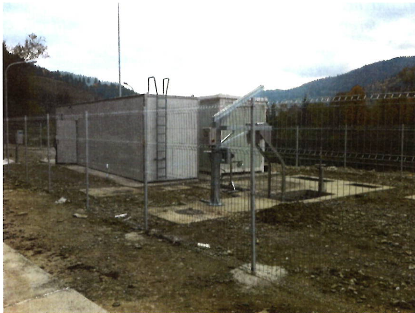
Stație de tratare ape uzate, tip SBR
